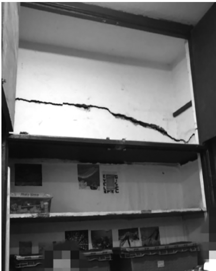
Imagem 2. Reportagem do Jornal Extra , 13/05/2016, que mostra as condições estruturais precárias da unidade escolar com grandes rachaduras nas salas de aula.
